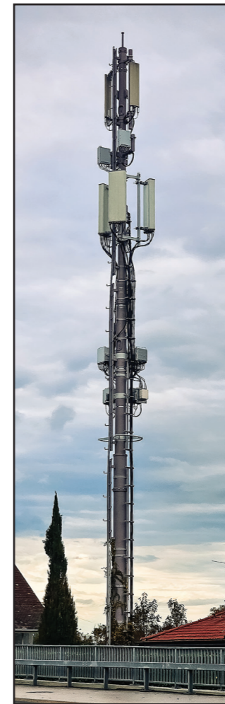
Photo d'illustration d'une antenne située sur la route de Lausanne entre Bellevue et Versoix.
