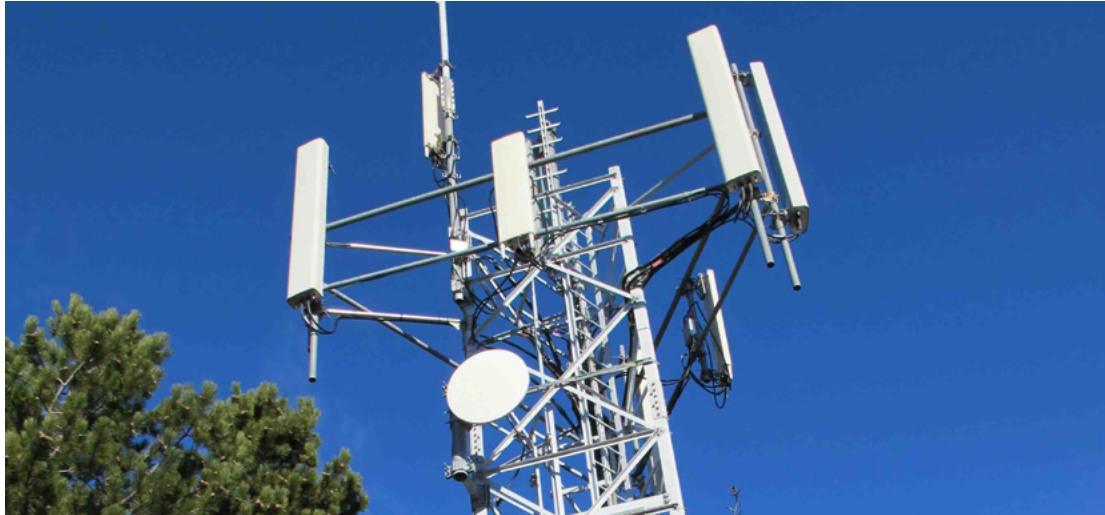
Support métallique avec différentes antennes pour les fréquences 2G/3G/4G
